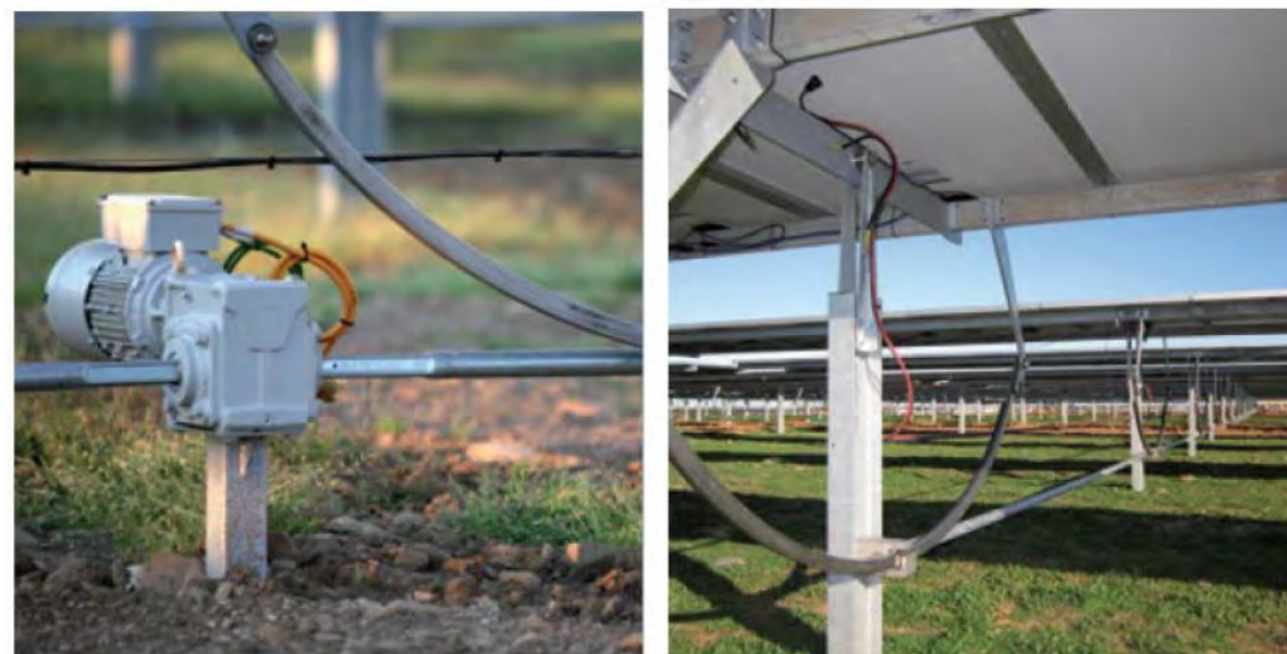
Moteurs et câblages de la centrale
