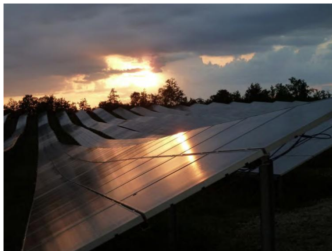
Centrale solaire du Sycala
