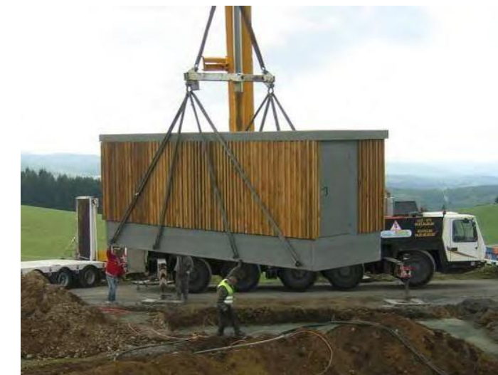
Exemple de livraison d'un poste de transformation sur un parc éolien
